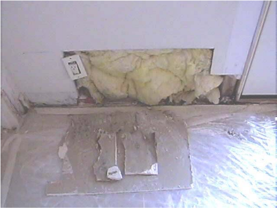
Mold on Drywall
